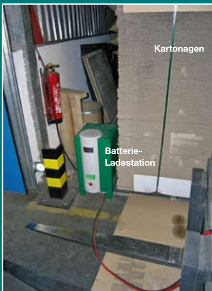
Nicht zulässiger Standort einer Batterie-Ladestation.
