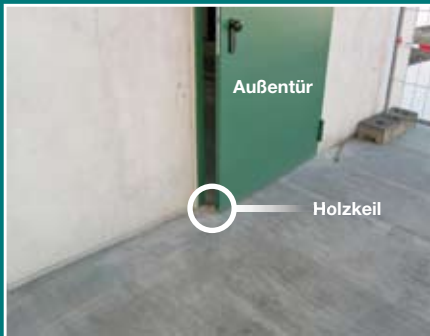
Durch Holzteil offen verkeilte Außentür (Gefahr der Fremdbrandstiftung).
