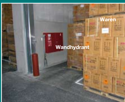
Durch Waren verstellter und somit nur eingeschränkt zugänglicher Wandhydrant.
