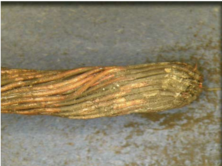
Bild 3 | Im Bereich des Pressverbinders sind die Litzen zusammengeschmolzen.
