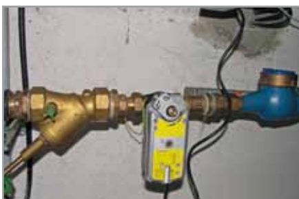
Bild 1 | Die erneuerte Trinkwasserinstallation im IFS wurde durch ein motorbetriebenes Absperrventil unmittelbar am Wasserzähler ergänzt.
