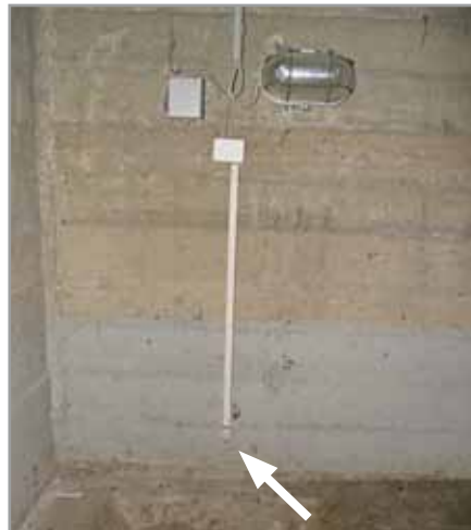
Bild 2 | Im Fahrstuhlschacht, der tiefsten Stelle des Gebäudes, wurde ein Wassermelder installiert.
