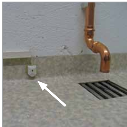
Bild 3 | Ein zweiter Wassermelder befindet sich in der Nähe des Fußbodens im Serverraum.
