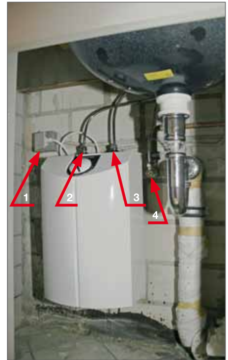
Bild 1 | Exemplarische Abbildung der Installation eines offenen Speichers. Der Pfeil 1 markiert den elektrischen Anschluss an eine Schutzkontaktsteckdose. Die Pfeile 2 und 3 markieren den Warmwasser- bzw. Kaltwasseranschluss an dem offenen Speicher. Der Pfeil 4 weist auf den Kaltwasserzulauf zu dem offenen Speicher von einem Eckventil aus.
