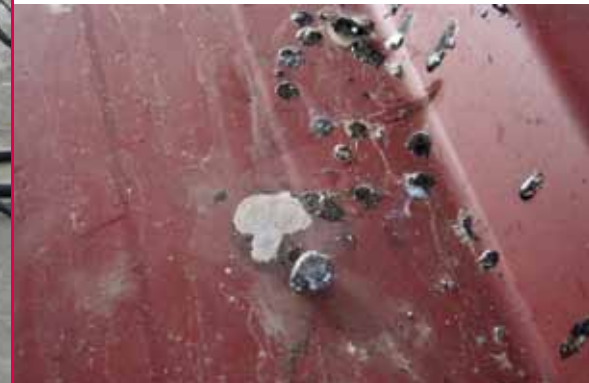
Brennend abgetropfte Modulbestandteile auf dem Dach, Quelle: Schaden VGH
