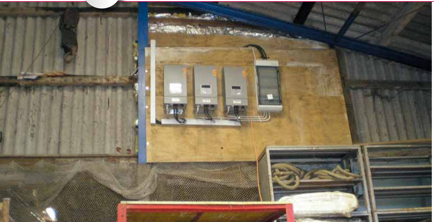
Unzugängliche Wechselrichter/Freischaltvorrichtungen, Quelle: VGH
