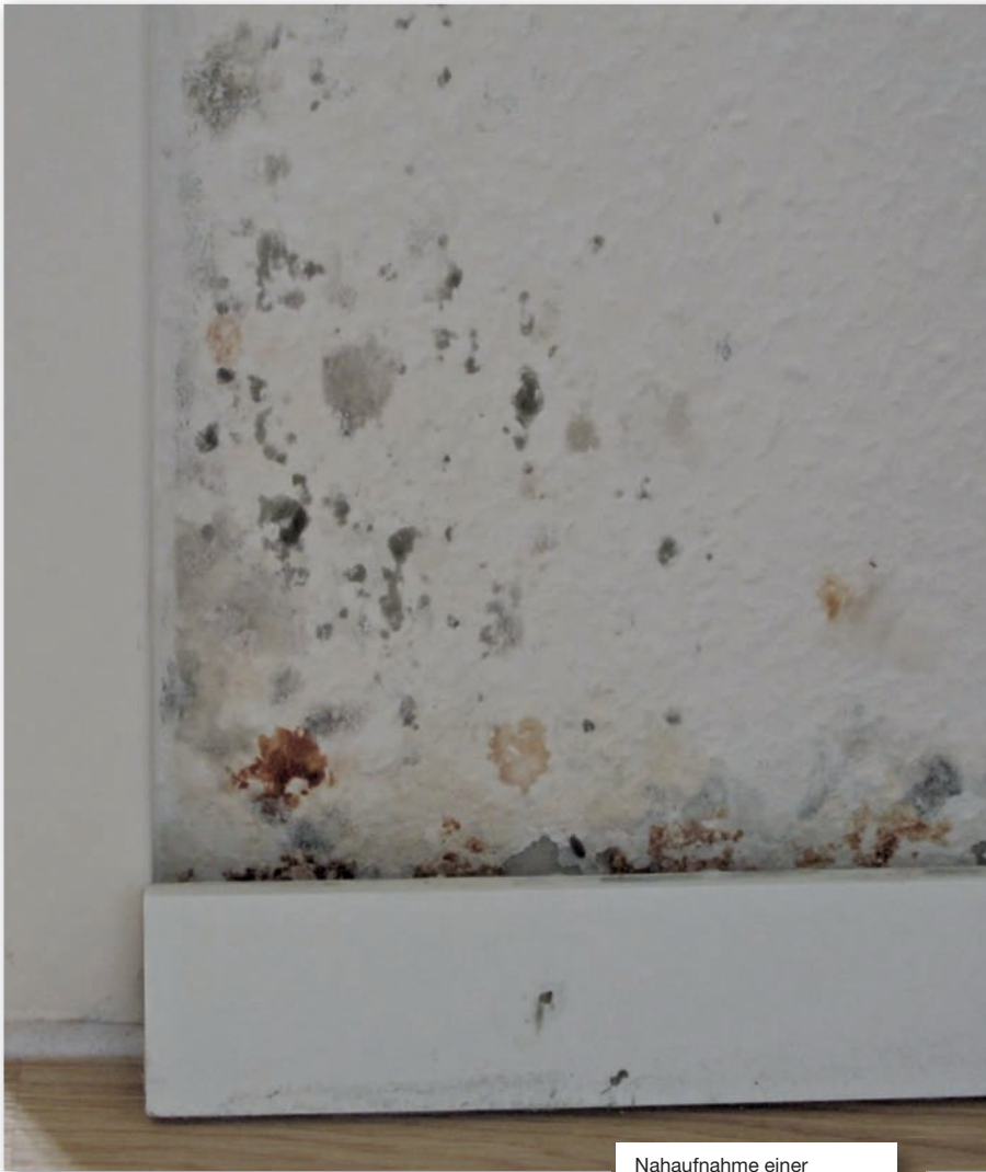
Nahaufnahme einer befallenen Gipskartonwand
