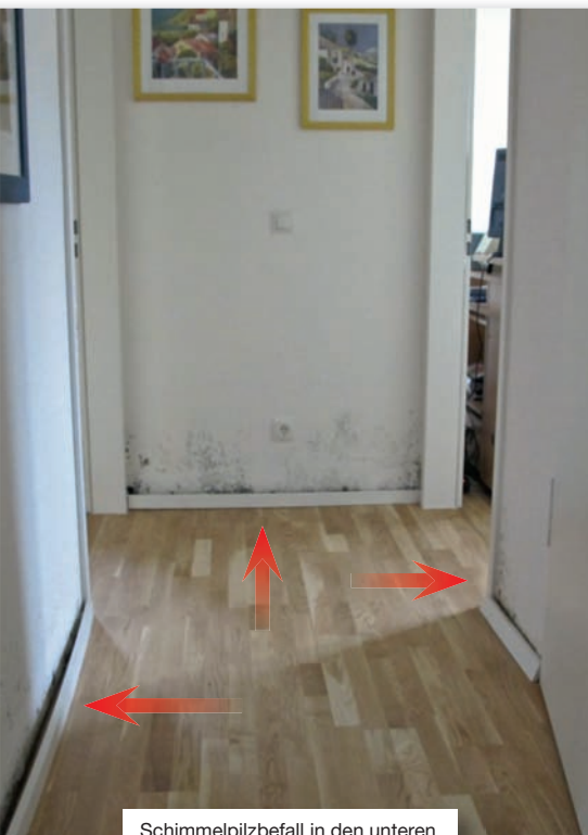
Schimmelpilzbefall in den unteren Wandbereichen im Flur ...
