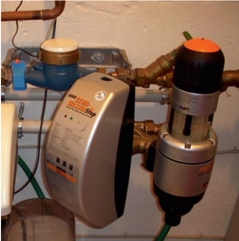
Bild 7 | Ein zweites Beispiel für empfehlenswerte Installationstechnik mit Feinfilter und Leckagedetektor
