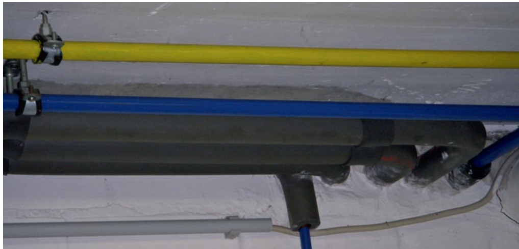
Bild 2 | Unter der Kellerdecke verlegte Leitungen bieten eine gute Zugänglichkeit.
