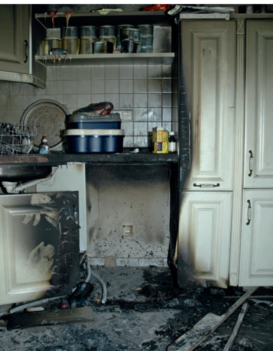
Bild 1 | Brandausbruchsbereich und Aufstellungsort des Geschirrspülers
