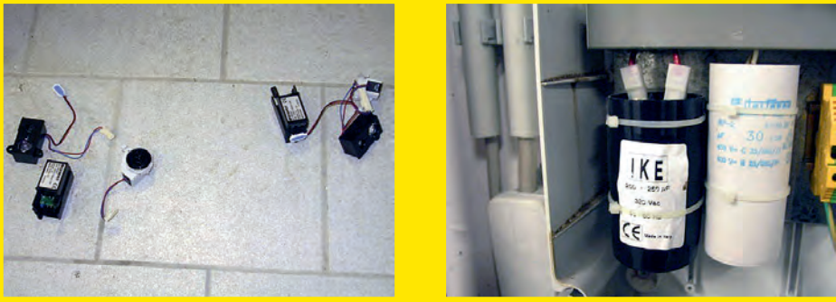
Bild 1 | Vom linken der beiden Urinale gingen zwei Wasserschäden aus. Bild 2 | Die ausgebauten Steuerungen, bestehend aus Netzteil, Elektronik und Magnetventil. Bild 3 | Der Anlaufkondensator für die Motorpumpe der Hebeanlage ist aufgebläht.
