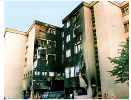
Bild 1 und 2 | Brandfall Adliswil (Schweiz) 1992, entnommen 1
