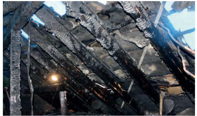
Bild 3 | Darstellung der Brandzehrungen im Spitzboden im Bereich der Solarkollektoren
