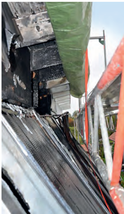
Bild 7 | Darstellung des Brandschwerpunktes im Anschlussbereich des Anbaus an das Wohnhaus
