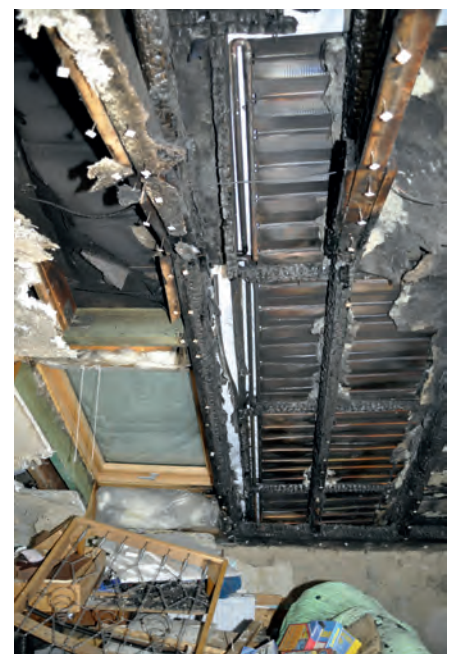
Bild 5 | Darstellung des Schadensschwerpunktes nach der Entfernung der Dachschrägenverkleidung
