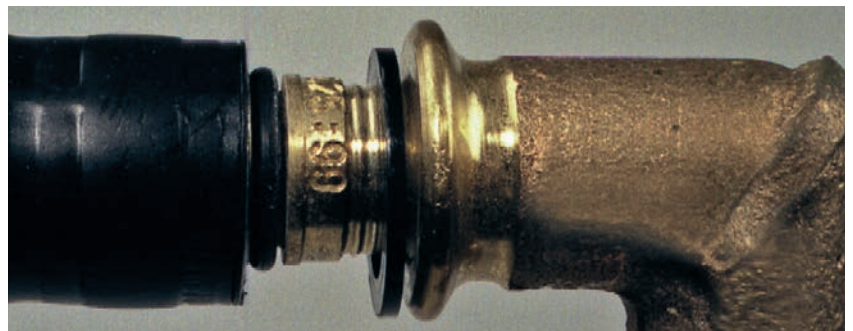
Bild 4 | Die Geberit Mepla-Verbindung wurde durch den extrem hohen Druck bei Frosteinwirkung über den O-Ring hinaus auseinandergedrückt. Die Verpressung selbst war fachgerecht erfolgt.
