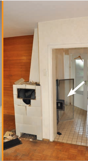
Bild 6 | Fall 5 | Blick auf die zerstörte Kachelummauerung. Der Pfeil deutet auf den Montageort des Ofens im Flur des Gebäudes.
