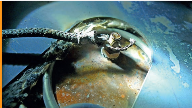
Bild 10 | Der „Thermofühler 1“ ist mit einer Ringöse am Brenntopf angeschraubt. Die Öse ist weitgehend abkorrodiert. Es besteht nur noch ein sehr kleinflächiger Kontakt.
