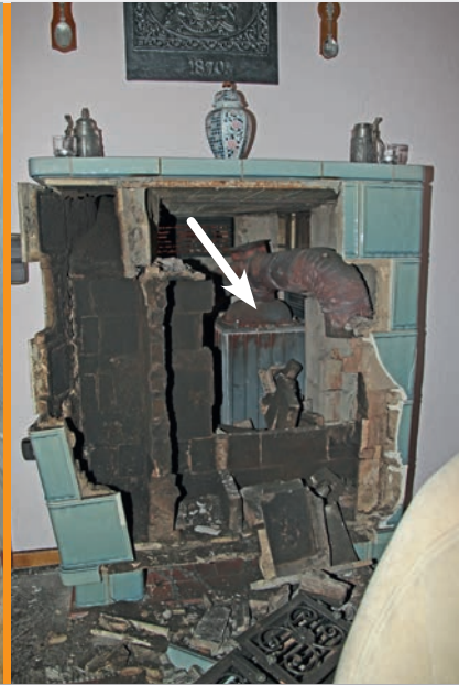
Bild 5 | Fall 4 | Die Ummauerungen wurden vollständig zerstört und Kacheln in die Wohnräume geschleudert. Der Pfeil deutet auf den ehemals hinter einer gemauerten Wand im Flur eingebauten Heizeinsatz „H 305“.
