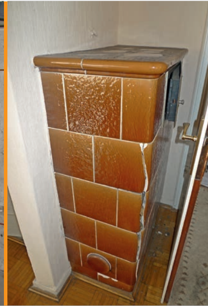
Bild 3 | Fall 2 | Einer der bei der Explosion zerstörten Warmluftauslässe
