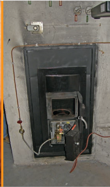
Bild 2 | Fall 1 | Neben einem Rußaustritt war es bei der Explosion an dem Heizeinsatz zur Abspregung der Rauchrohre gekommen. Die Explosion war bereits die zweite an diesem Heizeinsatz.
