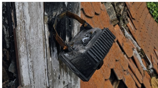
Bild 2 | Der Haltewinkel ist derart verformt, dass der Strahler nach unten gerichtet ist.
