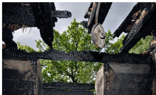
Bild 3 | Blick von innen auf den Brandausbruchsbereich
