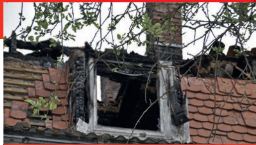
Bild 1 | An dieser Dachgaube kam es zum Brandausbruch.
