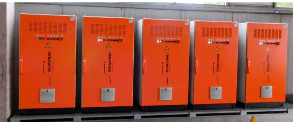
Bild 7 / Schaltschränke für die Ladeinfrastruktur der Firma Schaltbau
