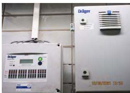
Bild 9 / Gasdetektoren für Wasserstoff in der Werkstatt
