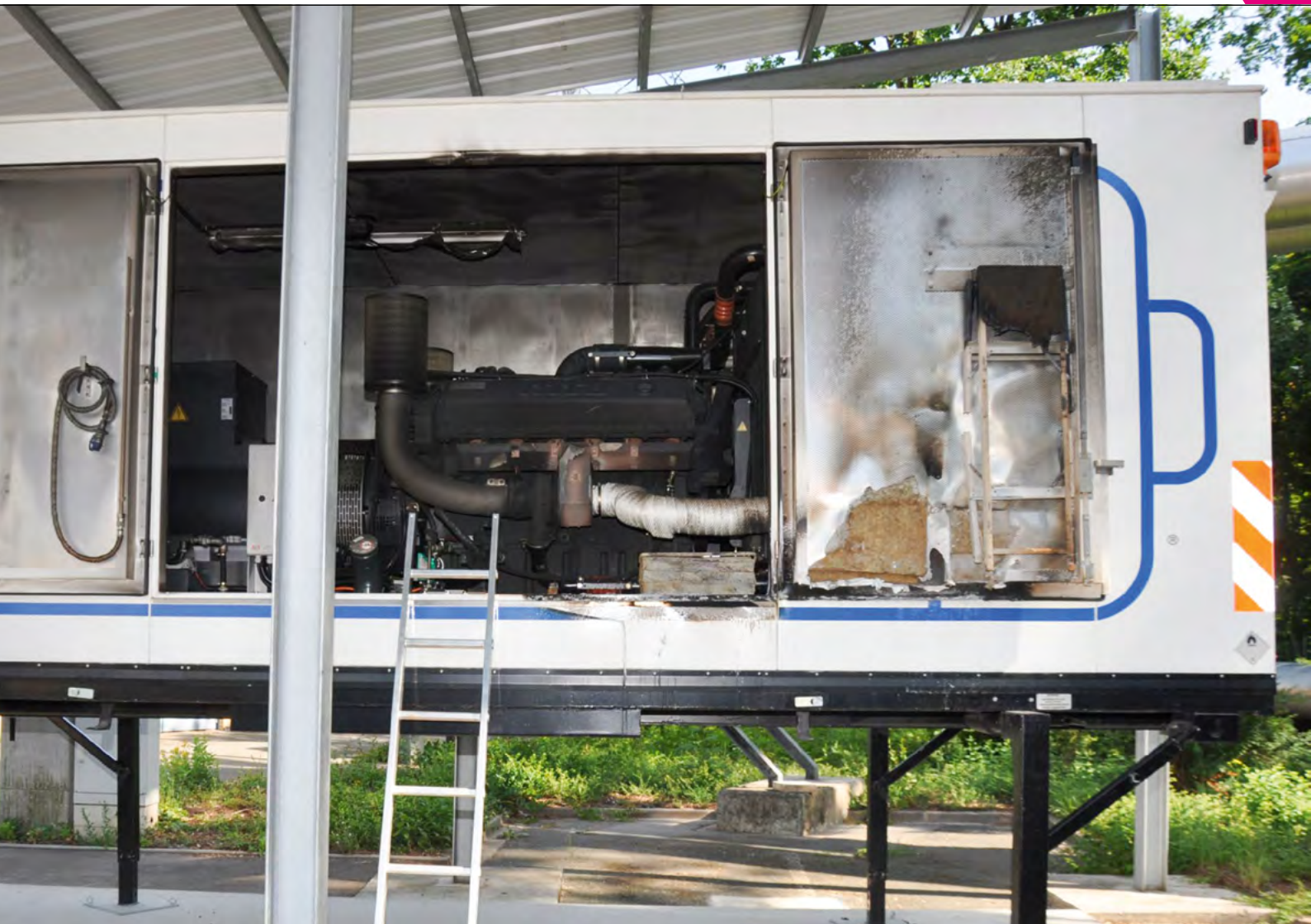
Bild 2 / Wegen einer beschädigten Leitungsisolierung kam es zum Kurzschluss und in der Folge zum Brandausbruch an diesem mobilen Notstromaggregat.
