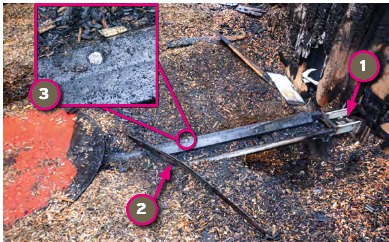
Bild 9 / Übersichtsaufnahme des beräumten Hackschnitzellagers: 1) Außerhalb des Bunkers sind in der Austragung keine verkohlten Hackschnitzel vorhanden. 2) Federblattarm, der über den Boden streift 3) Schraubenkopf mit offensichtlichem Materialabtrag
