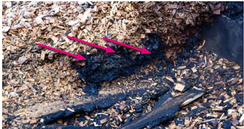
Bild 8 / Beim Beräumen eines Hackschnitzelbunkers wird in der untersten Schicht eine verkohlte Hackschnitzelzone (Pfeile) gefunden. Elektrotechnik war hier nicht vorhanden.
