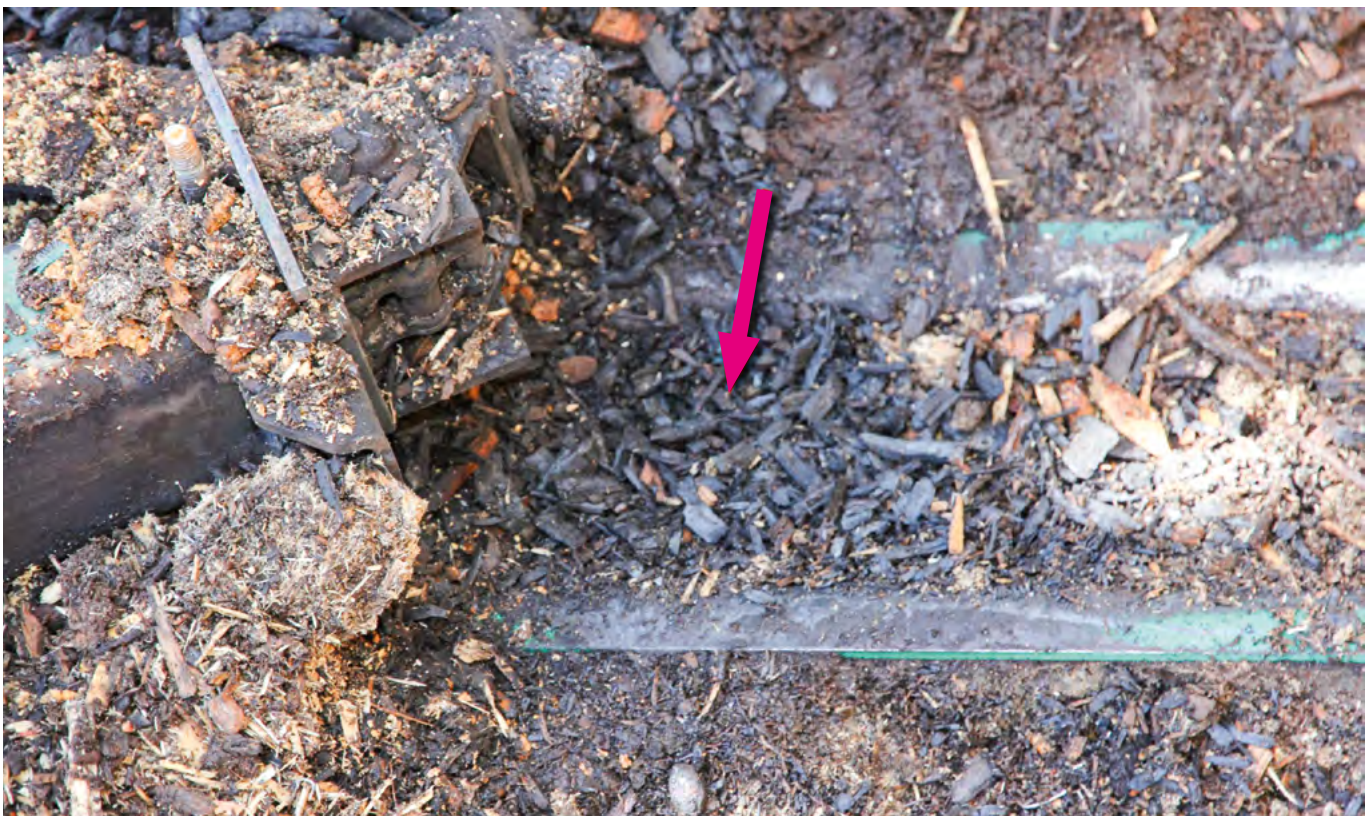
Bild 4 / In der Austragung aus dem Hackschnitzelbunker befinden sich verkohlte Hackschnitzelreste.
