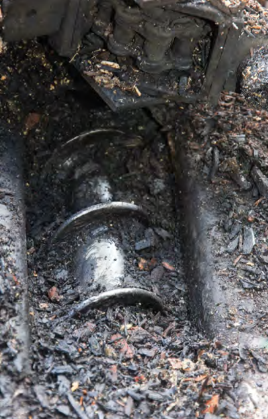
Bild 5 / Beim Freilegen zeigt sich, dass die Hackschnitzel nicht nur oberflächlich, sondern auch in der Tiefe in der gesamten Austragung verkohlt sind.
