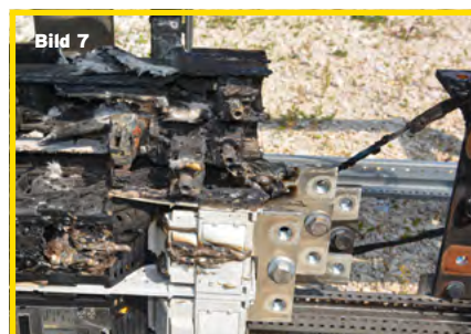
Bild 6 / Der Brandentstehungspunkt liegt im Fuß des Trichters. Dort befinden sich die Anschlussklemmen für die Aluminiumleitungen der PV-Anlage. Die Bezeichnungen L1 - L3 stehen für die drei Außenleiter.
