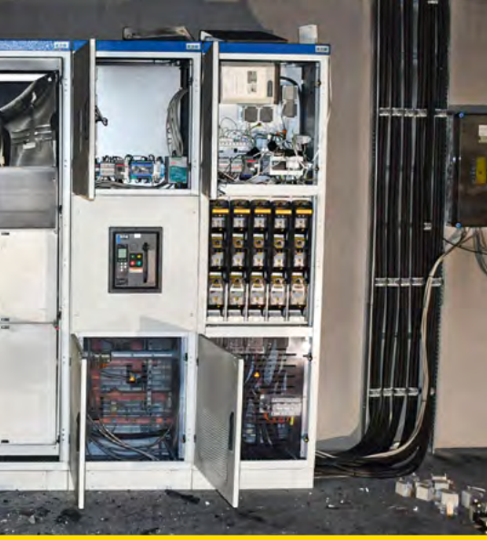
Bild 5 / Übersicht der NSHV: Der Brand entstand im Anschlussbereich der NH-Sicherungsschaltleisten an der linken Seite (Pfeil).
