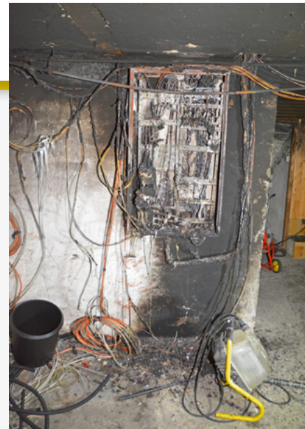
Bild 5 | Übersichtsaufnahme des Brandschwerpunktes
