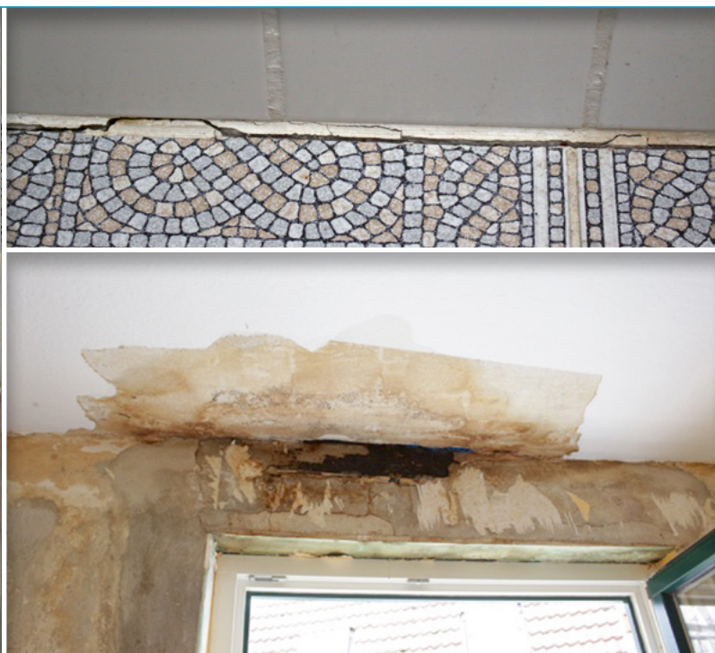
Diese Fuge im Bad ist nicht mehr dicht (oben). Hier kann Wasser – und das fällt in Bädern und Duschen sicher regelmäßig an – in das Bauwerk gelangen. In diesem Fall führte es zu einem Pilzbefall der Holzbalken in der darunter liegenden Außenwand (unten).
