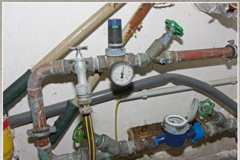
Bild 2 | Auch am Hausanschluss des Wellness-Studios zeigen sich deutliche Korrosionsspuren.
