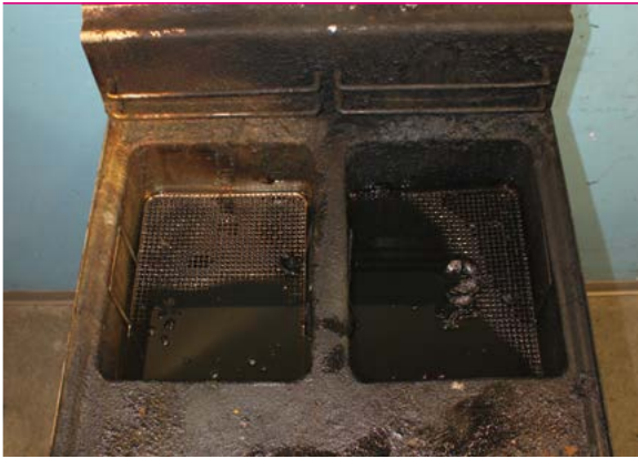
Bild 5 | Ausgebaute brandgeschädigte Fritteuse
