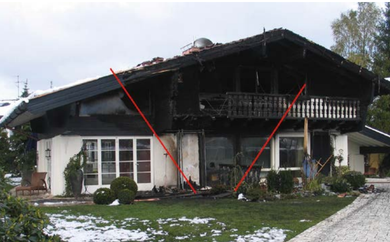
Bild 5 | An der Fassade dieses Wohnhauses war es zu einem Brandgeschehen gekommen. Im Fußpunkt der Brandzehrungen hat eine Laterne gestanden.
