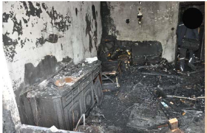
Bild 7 | Die vom Brandschaden betroffene Wohnung weist im Wohnzimmer einen hohen Zerstörungsgrad auf. Ein auffälliges Spurenbild ergab sich aber im Bereich des Ecksofas und des nebenstehenden Schränkchen (links im Bild), auf dem ein Grablicht gestanden hat.
