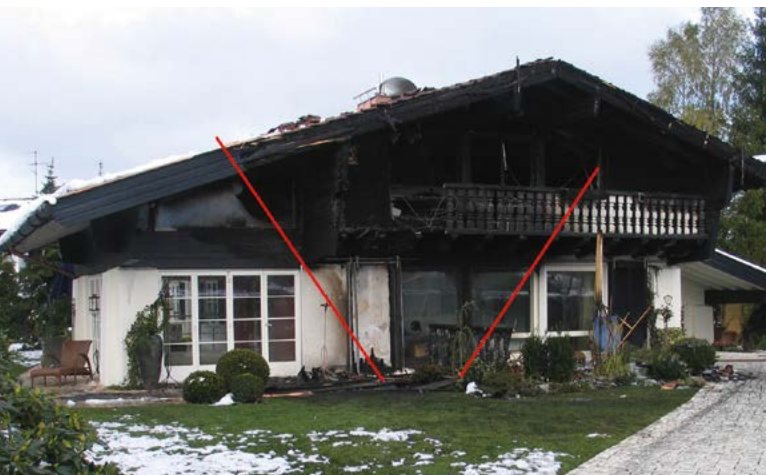
Bild 5 | An der Fassade dieses Wohnhauses war es zu einem Brandgeschehen gekommen. Im Fußpunkt der Brandzehrungen hat eine Laterne gestanden.
