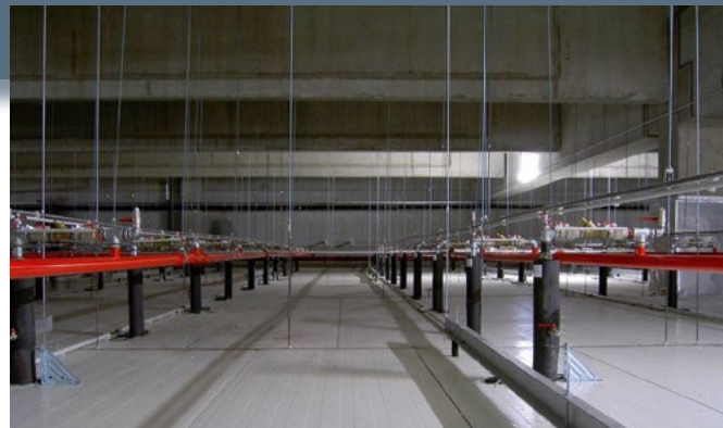
Bild 3 | Ansicht einer Zwischendeckeninstallation einer Sprinkleranlage @ Fa. MINIMAX
