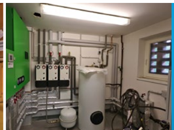
Bild 7 | Risikoklasse 3 In solchen Haustechnikzentralen laufen viele Leitungen zusammen. Hier erfolgt auch die Warmwasserbereitung. Das Risiko für einen Schaden in einem solchen Raum ist hoch.
