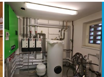
Bild 7 | Risikoklasse 3 In solchen Haustechnikzentralen laufen viele Leitungen zusammen. Hier erfolgt auch die Warmwasserbereitung. Das Risiko für einen Schaden in einem solchen Raum ist hoch.
