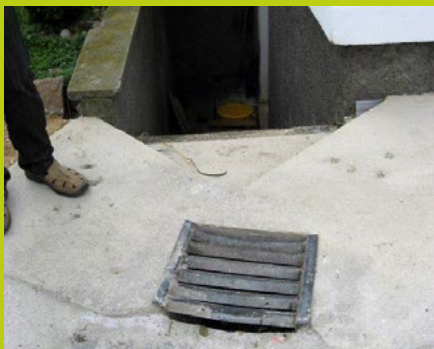
Bild 1 | Bei Überlast wird der Keller überflutet.
