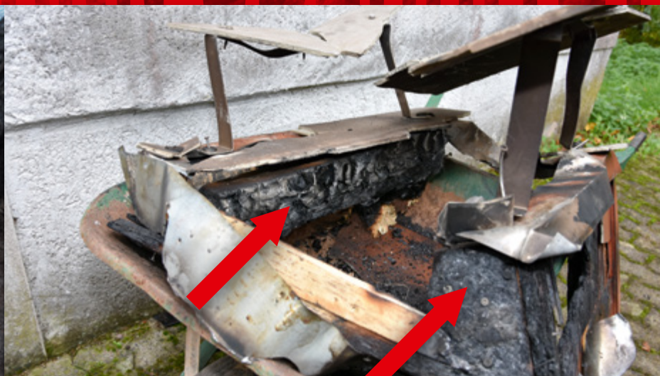
Bild 3 | Die Verkleidung des Schornsteinkopfes: Die beiden markierten Kanthölzer lagen vor dem Brandausbruch direkt auf dem Schornsteinkopf.
