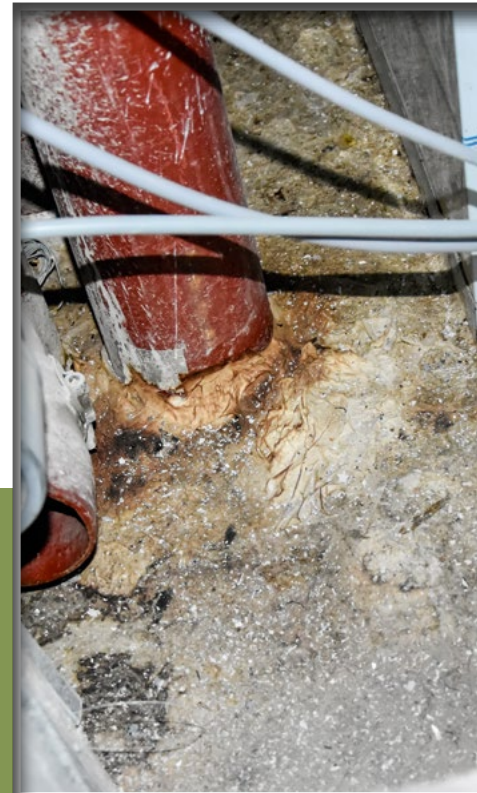
Ausgetretene Fäkalien und Toilettenpapier aufgrund einer Leckage an der Abwasserleitung
