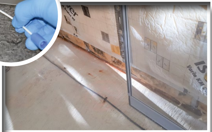
Zurückgebauter Bodenaufbau nach einem Fäkalschaden: Die Beplankungen der Ständerwände müssen noch entfernt werden.
