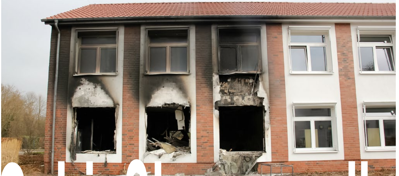
Bild 1 | Im Erdgeschoss wurden mehrere Fensterelemente herausgeschleudert; die größten Schäden liegen am dritten Fenster von links vor.
