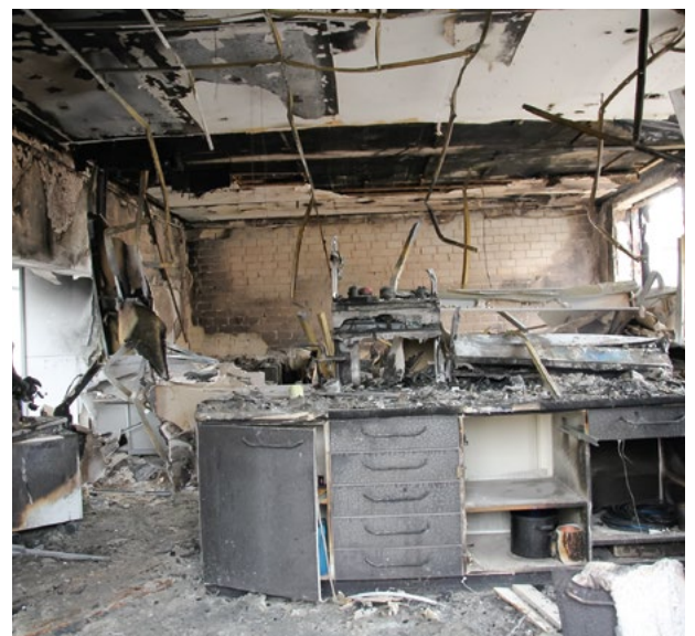
Bild 2 | Brand- und Explosionsschäden im Labor
