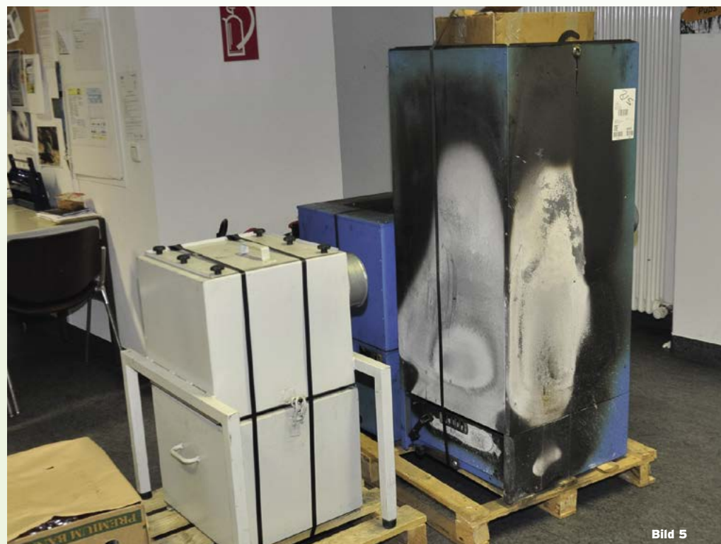
Bild 5 / Ansicht der asservierten Komponenten der Absauganlage
