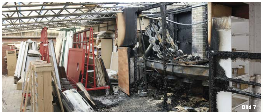
Bild 7 / Ansicht des hauptsächlich vom Brand betroffenen Bereichs mit der Absauganlage
