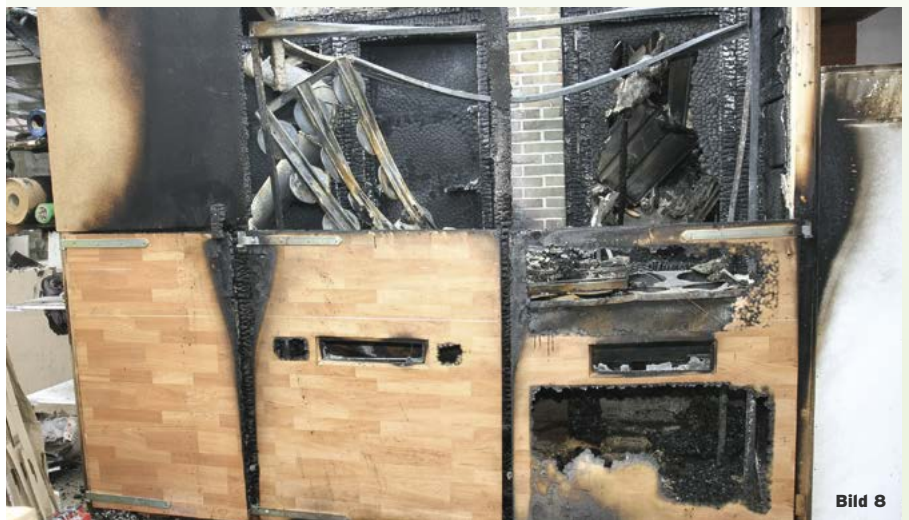
Bild 8 / Rekonstruktion der aus dem Brandschutt gesicherten Reste der hölzernen Verkleidung der Absauganlage
