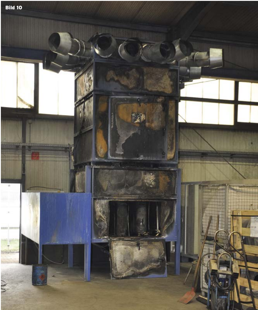
Bild 10 / Absauganlage innerhalb eines Betriebsgebäudes: Im Inneren mussten hier aufgrund der Verruptionen umfangreiche Sanierungsmaßnahmen durchgeführt werden.
