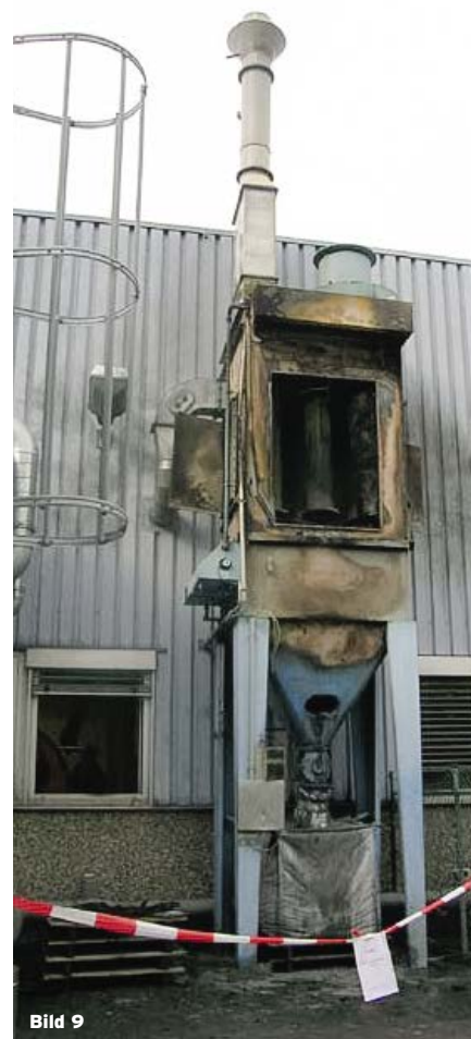
Bild 9 / Absauganlage außerhalb des Gebäudes: Die Schäden blieben hier weitgehend auf die Absauganlage beschränkt.
