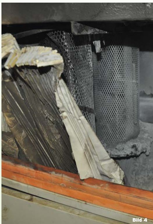
Bild 4 / Blick in die Filtereinheit mit den weitgehend bis auf die metallenen Komponenten verbrannten Filterpatronen
