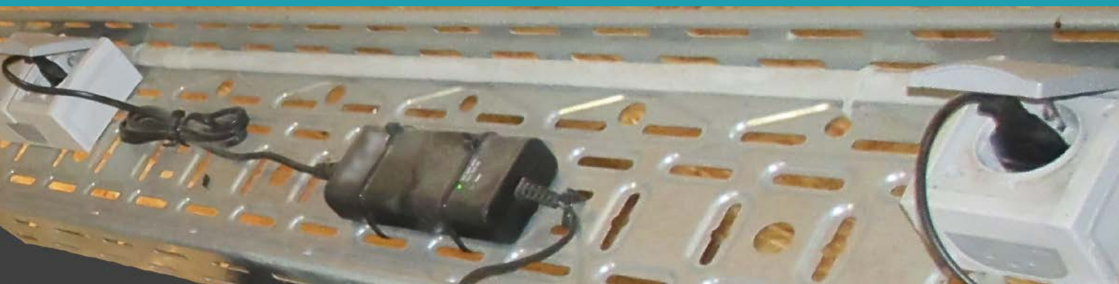
Bild 6 / Kabelbühne mit ausreichend Platz für fest installierte Steckdosen und sicherer Ablage für die Ladegeräte
