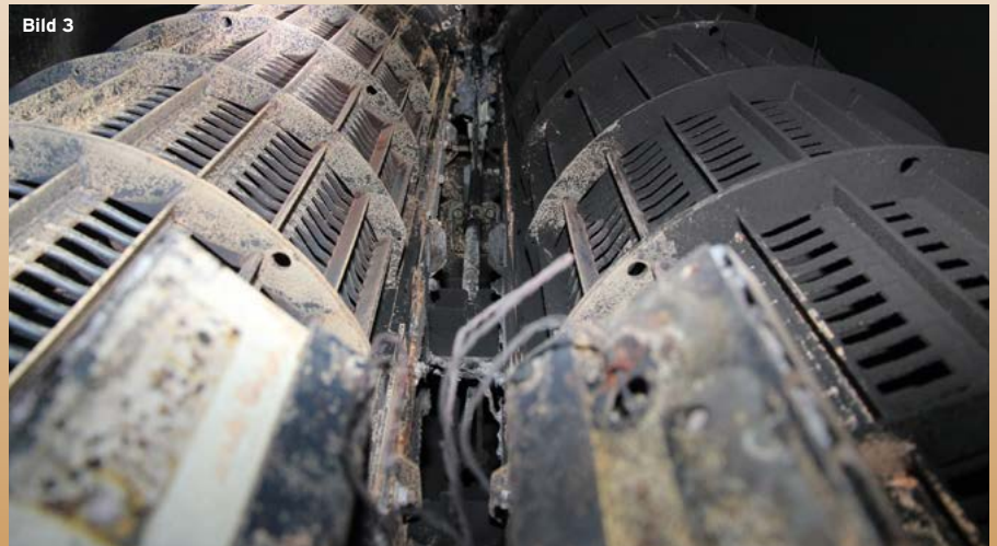
Bild 3 / Die Rotoren zur Restkornabscheidung sind unterschiedlich stark brandbetroffen.
